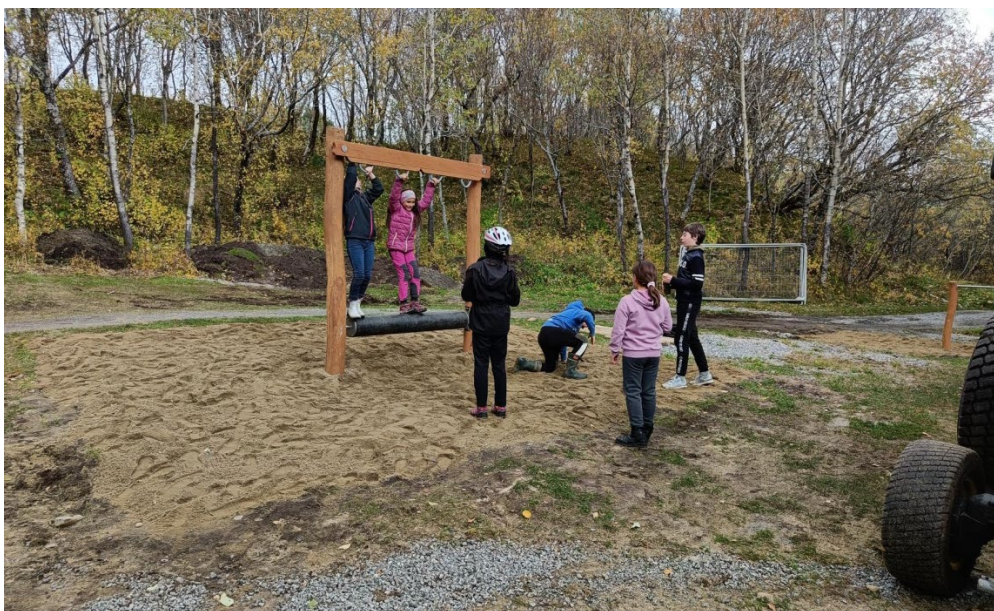
Illustrasjon 7: Et område som inkluderer både trimpark og gapahuk er under opparbeidelse ved Sandneselva.
