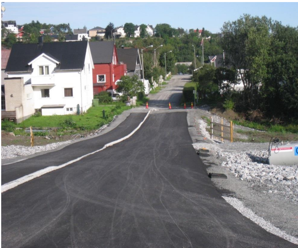
Illustrasjon: Arbeidet med etablering av fortau ved Sandnes skole er i gang. Foto: Alstahaug kommune
