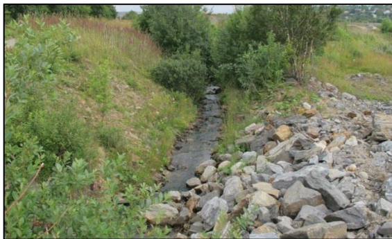
Figur 10 På de øverste 40 m innenfor planområdet går bekken i en kunstig anlagt grøft. De resterende ca. 140m går bekken i rør. Foto: Oddmund Wold.
